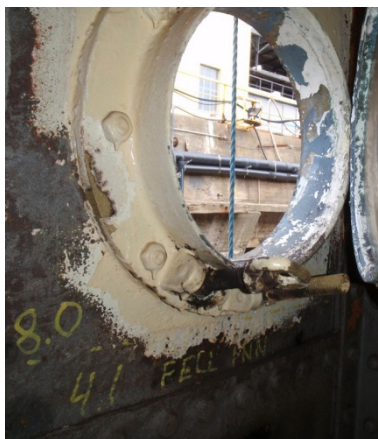
Rusttæring under lysventil på D/S Kysten. Tallene til venstre i bildet angir tykkelsesmål i hudplata etter måling med ultralydapparat. Som vi ser er hudplata i underkant av lysventilen kun halvparten av tykkelsen ellers (Foto: Thomas Olsen 25.10.10)
