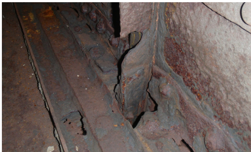
Eksempel på korrosjonsskader i fra Dampskipet Kysten. Slik så hoveddekket ut etter at betongen var meislet bort. Store rustskader i rennestein og spant gjennomgående dekk (foto: Thomas Olsen 25.10.10).
