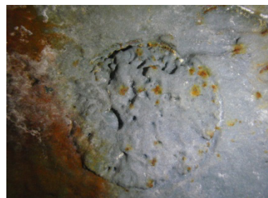
Groptæring på selve naglehodet, D/S Kysten. Dette kan skyldes slitasje av maling i området eller dårlig overflatebehandling (foto: Thomas Olsen 25.10.10)
