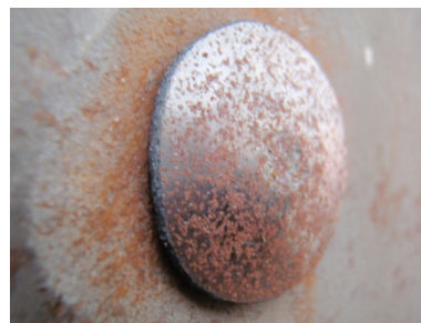
På og rundt nagler som mangler sinkprimer oppstår forholdsvis raskt rustdannelse (foto: Thomas Olsen 26.10.10)
