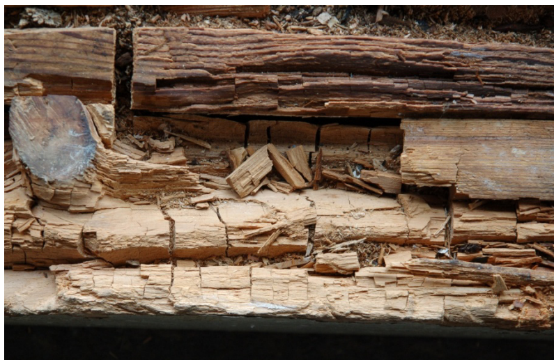
Angrep av brunråtesopp. Treverket sprekker opp på tvers av fiberretningen.
