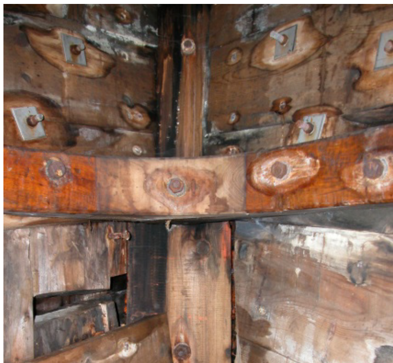
Rustne jernbolter danner lut-råte med misfarging og begynnende nedbrytning av treverket som følge.
