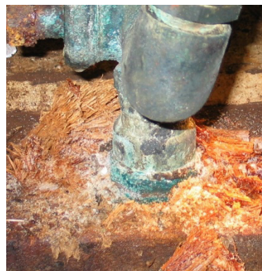
Lut-råte ved ei gjennomføring. Treverket blir misfarget og blir til løse tråder. Vi ser også den karakteristiske saltutskillelsen.
