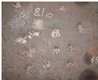
Sveisede groptæringer i hudplate. (foto: BDF.)
